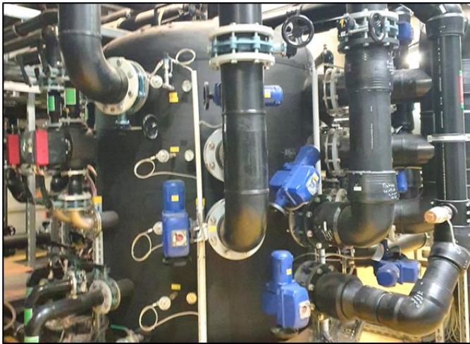
Am Standort in der Halle 18 im VW Werk Emden umgesetzter „flinker Speicher“
