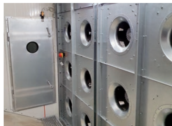
Saugseitige Ansicht einer der neuen Anlagen inklusive individuell angefertigter Revisionstür.
