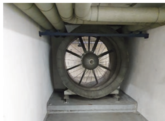
Ansicht auf einen der alten Axialventilatoren aus dem Jahr 1975.
