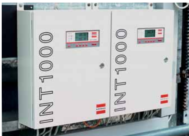
Ein Öl-Niedertemperatur-Gussheizkessel Logano GE515 versorgt die Gärtnerei Böhringer. Die Klimacomputer von Kriwan steuern die unterschiedlichen Einstellungen in den sechs Gewächshausabteilen und geben die Wärmeanforderung an den Kesselregler weiter.
