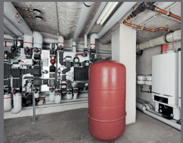
Die gewonnene Energie wird in den Pufferspeicher übertragen.
