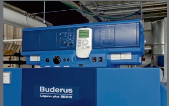
Wirtschaftlichkeit geregelt: Dank der Kesselgrundregelung Logamatic 4321 deckt der Gas-Brennwertkessel effizient die Spitzenlast.
