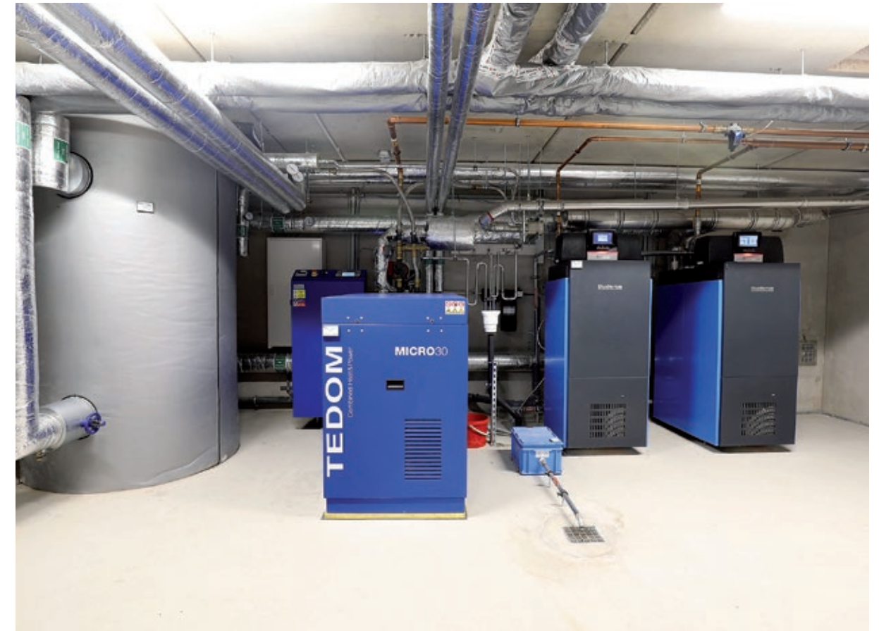
Ein Blockheizkraftwerk ist zentraler Bestandteil des Konzepts "Sichere Energieversorgung kritischer Infrastrukturen" – kurz SEKI.
